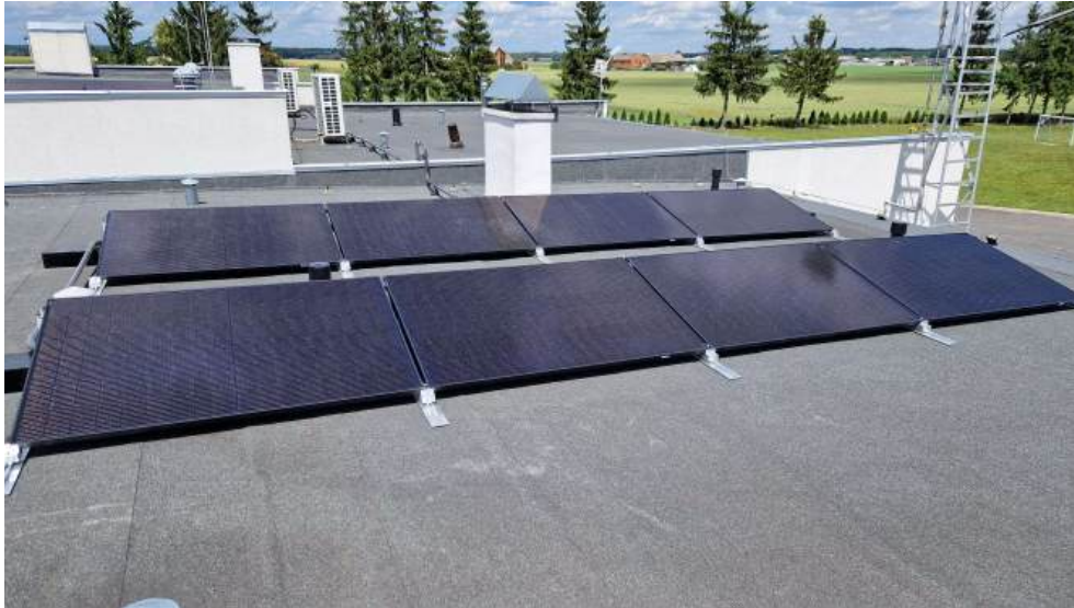
Fot. 11. Instalacja fotowoltaiczna na budynku świetlicy w Babkowicach
