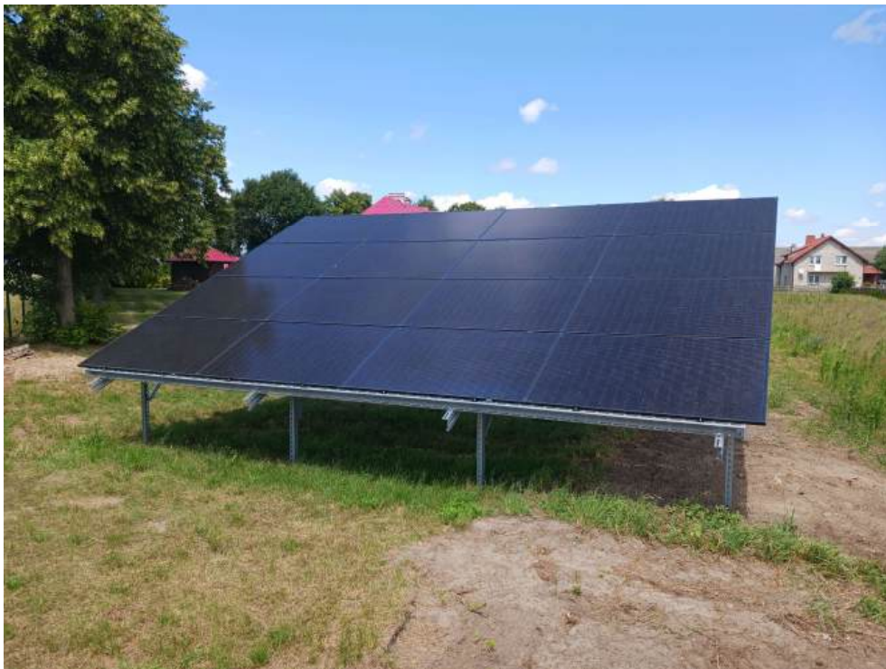
Fot. 12. Instalacja fotowoltaiczna przy świetlicy wiejskiej w Pasierbach
